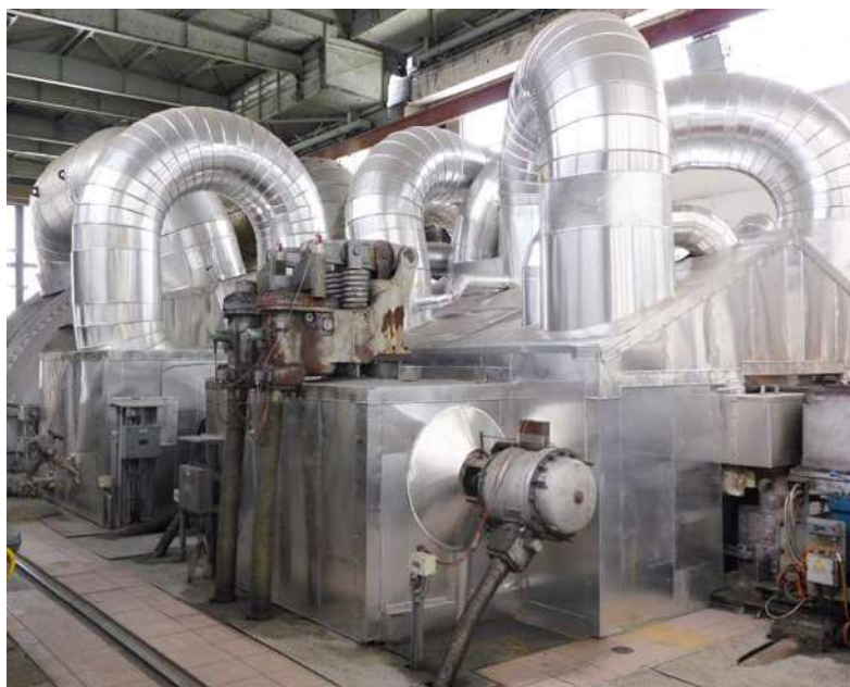
Vysokotlaká část turbíny a izolovaná parní potrubí
