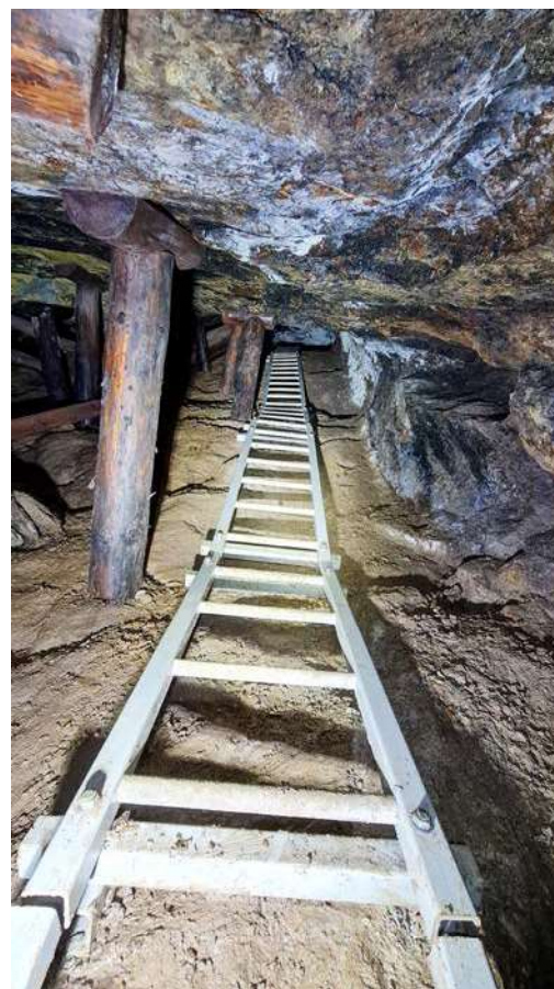
Obr. 3 Přečtová komora mezi Starým patrem a Petrovým obzorem
