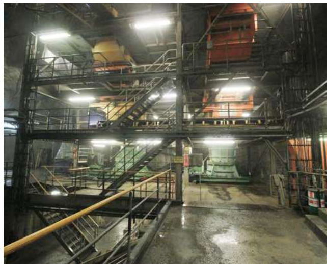
Obr. 33 Technologie podzemní primární úpravy
