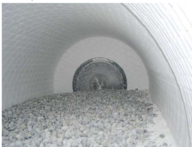
Pohled do mlecího zařízení firmy Minorit. Foto Fluorit Teplice s.r.o.
